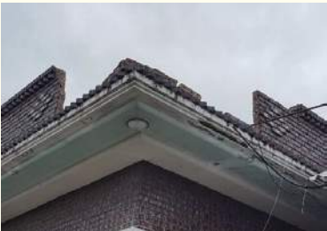
• 주택 지붕 난간 파손
