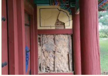
• 신문왕릉 벽체 파손
