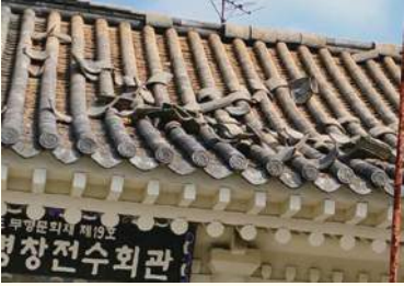
• 무형문화재 전수관 지붕 기와 파손
