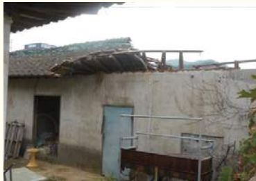
• 창고 지붕 파손
