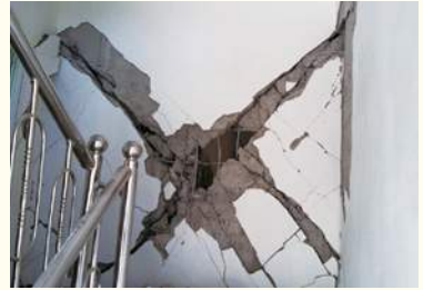
• 장량동 기예공 주택 내벽 파손
