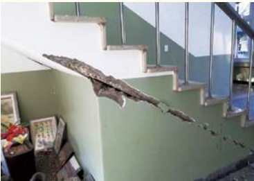
• 포항흥해공고 계단 균열
