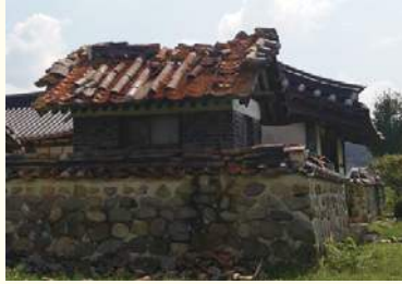
• 사마소 지붕 기와 파손
