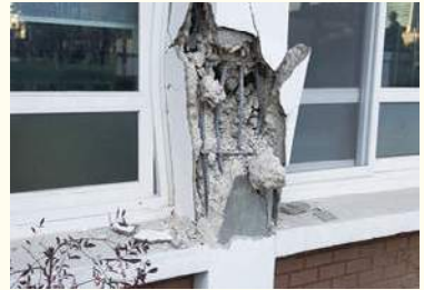
• 흥해초등학교 건물 기둥 파손
