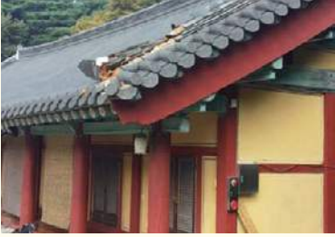
• 불국사 지붕 기와 파손
