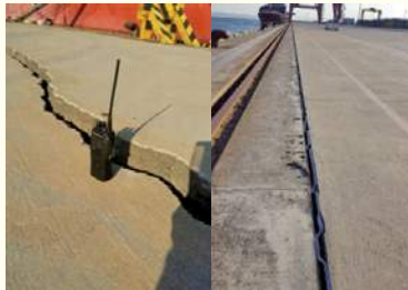
• 영일만 부두 지반 균열
