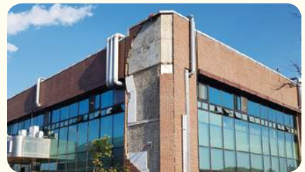
건물 외벽 탈락
