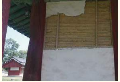
• 경주 향교 벽체 파손
