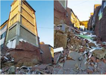
• 환여동 대동빌라 외벽 탈락
