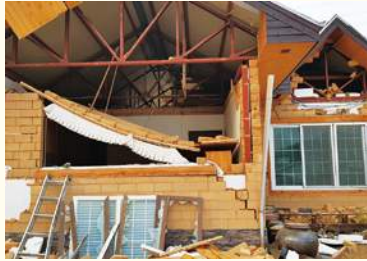
• 장량동 주택 외벽 파손
