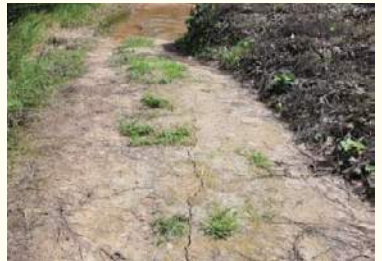
• 사곡지 저수지 둑 균열
