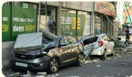
낙하물 차량 파손
